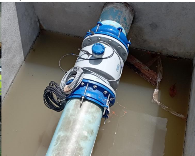
Macro medidor Pedrinhas/Araxa instalado
